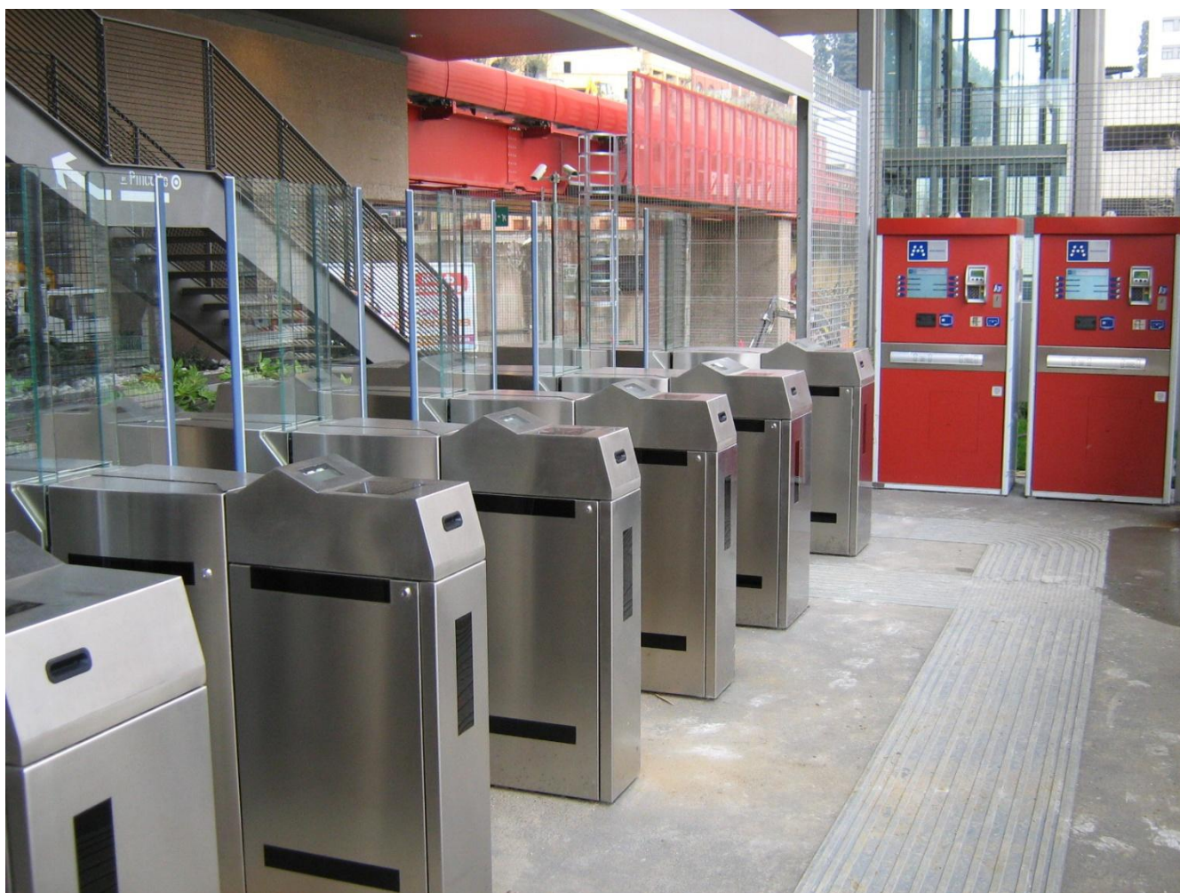
Varchi di metropolitana in batteria - sullo sfondo, emettitrici di biglietti self service (Minimetrom, Perugia)
